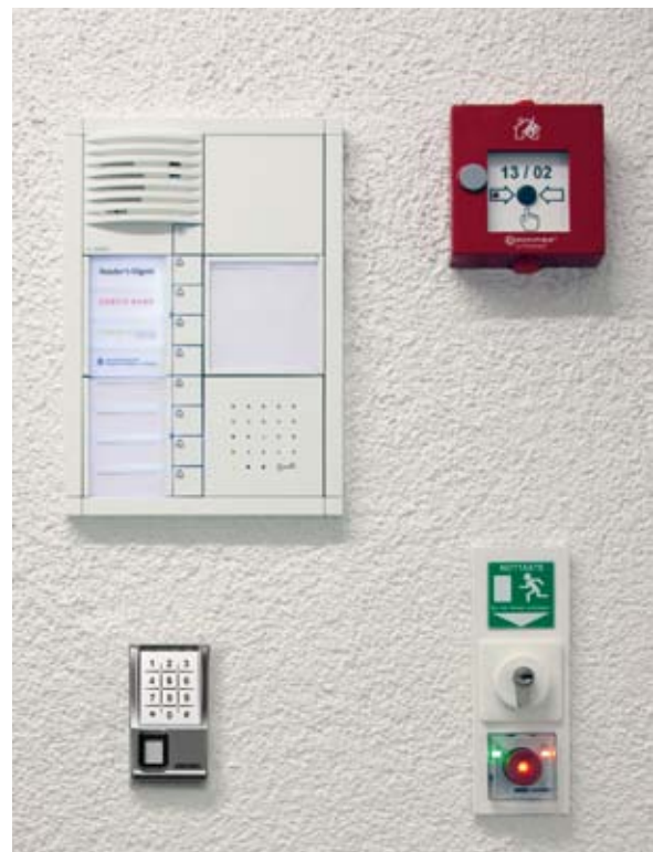
Das GEZE SecuLogic Rettungswegsystem ermöglicht die Verknüpfung von mehreren Systemkomponenten und die Übertragung von großen Datenmengen schnell und mit minimalem Kabelaufwand. © Nikolaus Grünwald / GEZE
