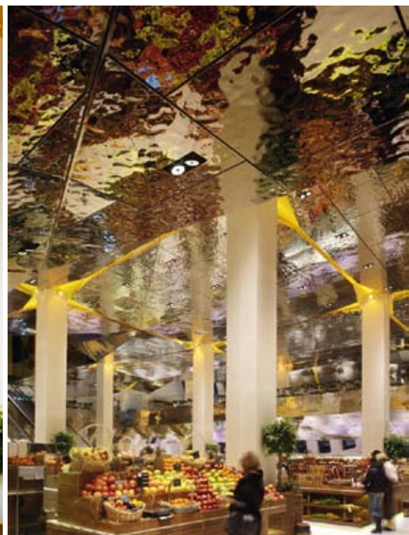
Tsvetnoy Central Market: Deckenpaneele aus gehämmertem, hochglanzpoliertem Edelstahl (Ausführung: Lindner Group KG)
